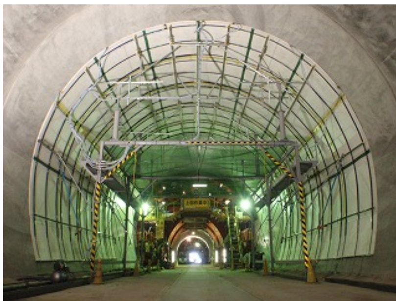
写真1 システム全景 (現場適用時)
