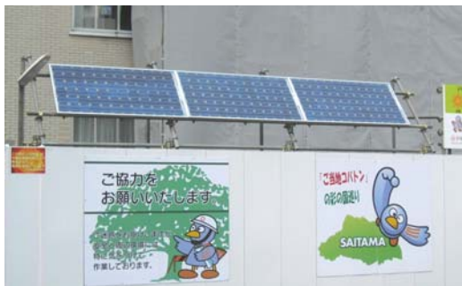
写真-1 仮囲いに設置した太陽光パネル
