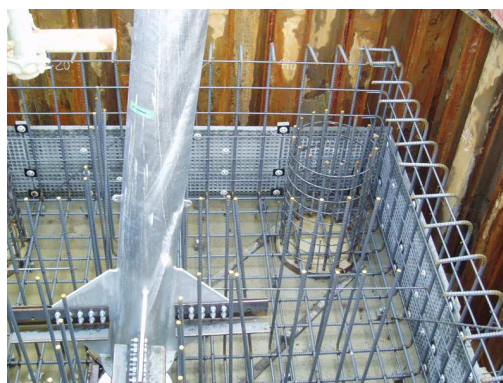
⑥ 送電線鉄塔基礎
