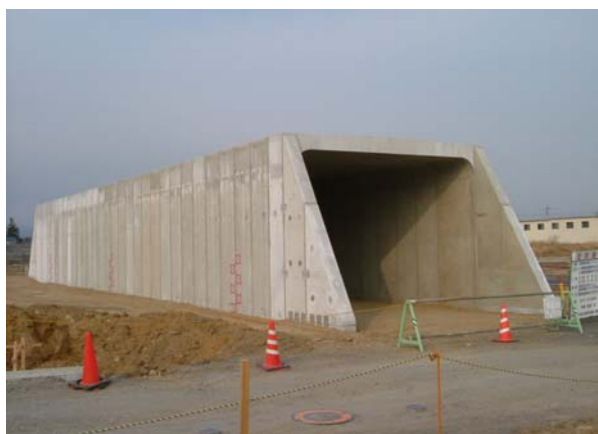
4分割ボックスカルバート B6000×H6300 日本道路公団 高崎工事事務所
