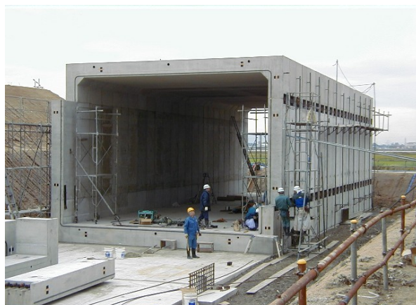
4分割ボックスカルバート B8000×H6000 国土交通省 新潟国道事務所
