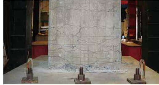
「タフナット」を用いた試験体の試験後状況
