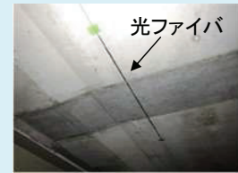
光ファイバ設置状況(床版下面)
