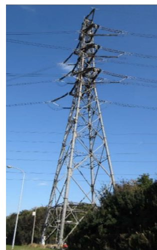
写真-1 千葉火力線 鉄塔 (設置後 18 年経過赤錆の発生なし。表面が黒色化)
