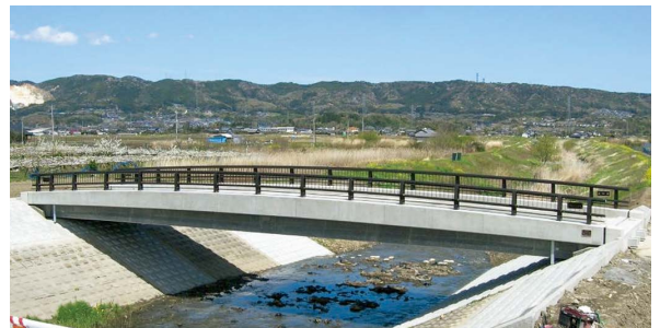
写真-3 「ダックスビーム」を使用したPC桁橋
