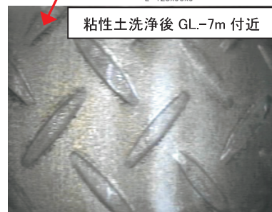
図7 継手内洗浄後の縞鋼板の状況
