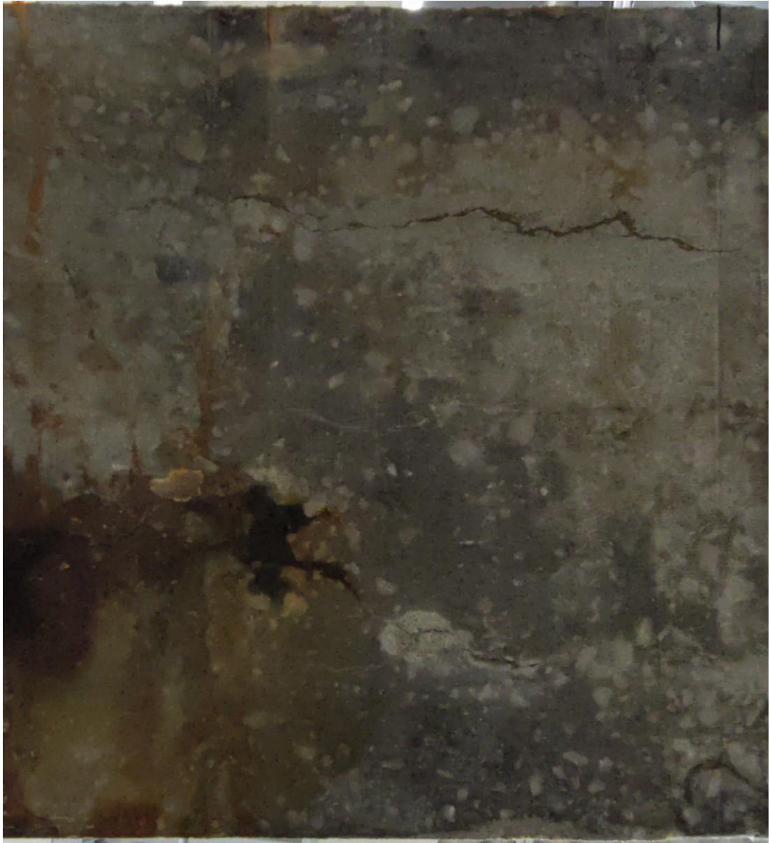
写真 4-3 Skydio で撮影された腐食ひび割れ画像例（供試体 C3：電食終了後）
