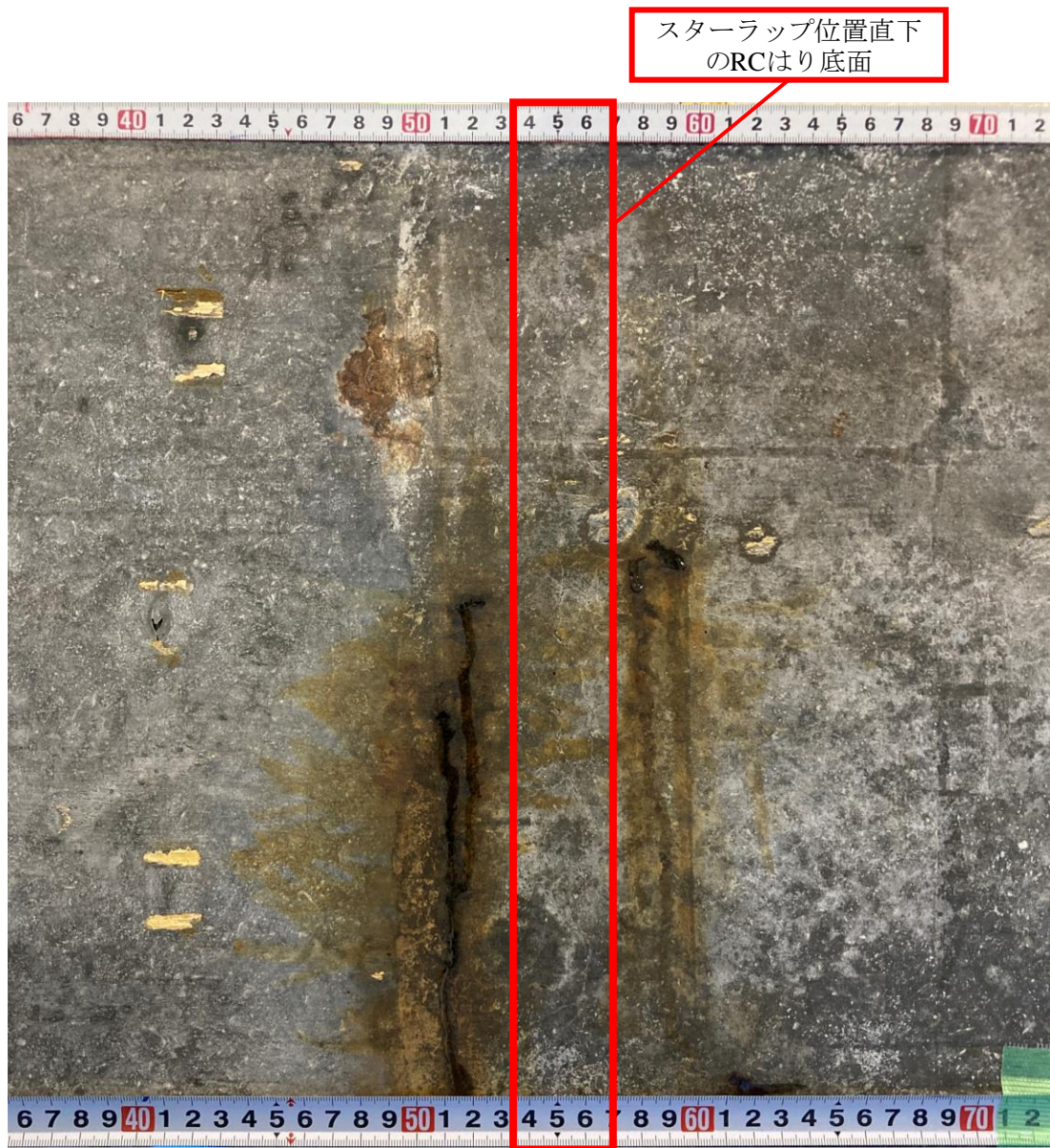
写真 4-1 スターラップ位置直下の RC はり底面に生じた腐食ひび割れの例（供試体 C1）
