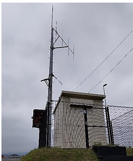
図-1 河川水位計の例（阿武隈川本宮水位観測所） 2022年6月著者撮影
