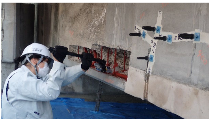
図-5 桁での近接撮影
