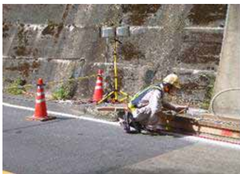
写真 3-1 RFID の設置状況
