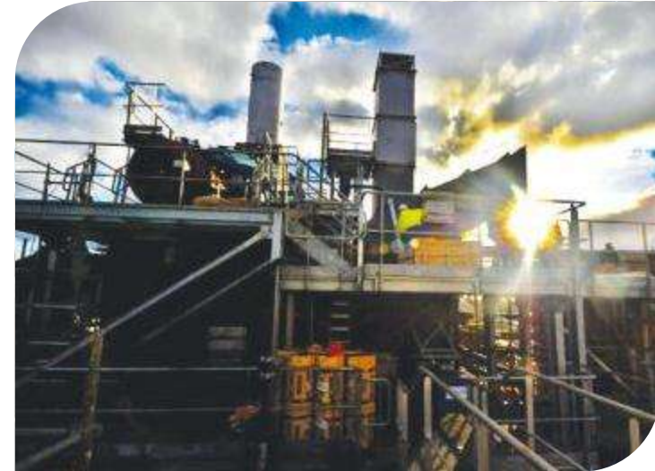
廃棄物再処理場 - Villejuste (91)(フランス)
