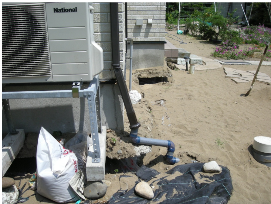
写真5.3.2 鋼管短杭打設した建物の被害（砂丘）
