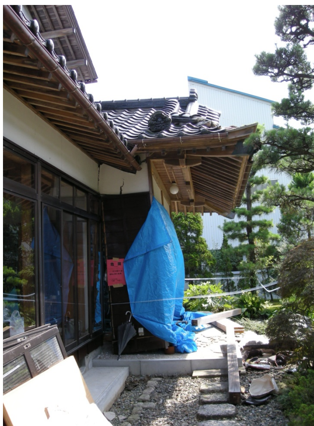
写真5.3.3 長尺鋼管杭を打設した建物の被害（砂丘間低地）
