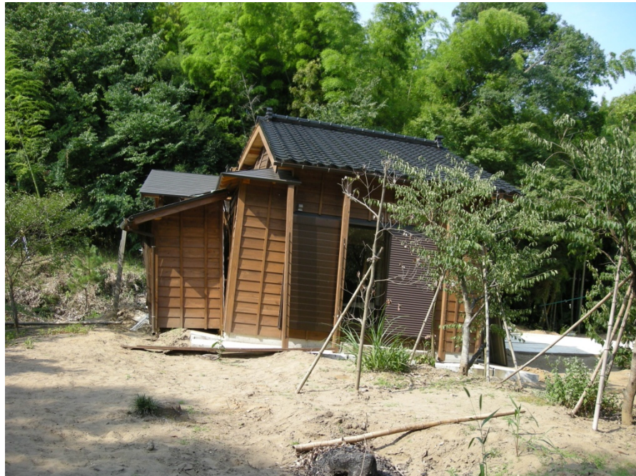
写真5.2.1 砂丘斜面の崩壊による建物の被害
