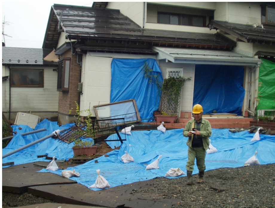
写真 2. 2. 3 盛土の崩壊による建物基礎の被害 ((株) 福田組提供)
