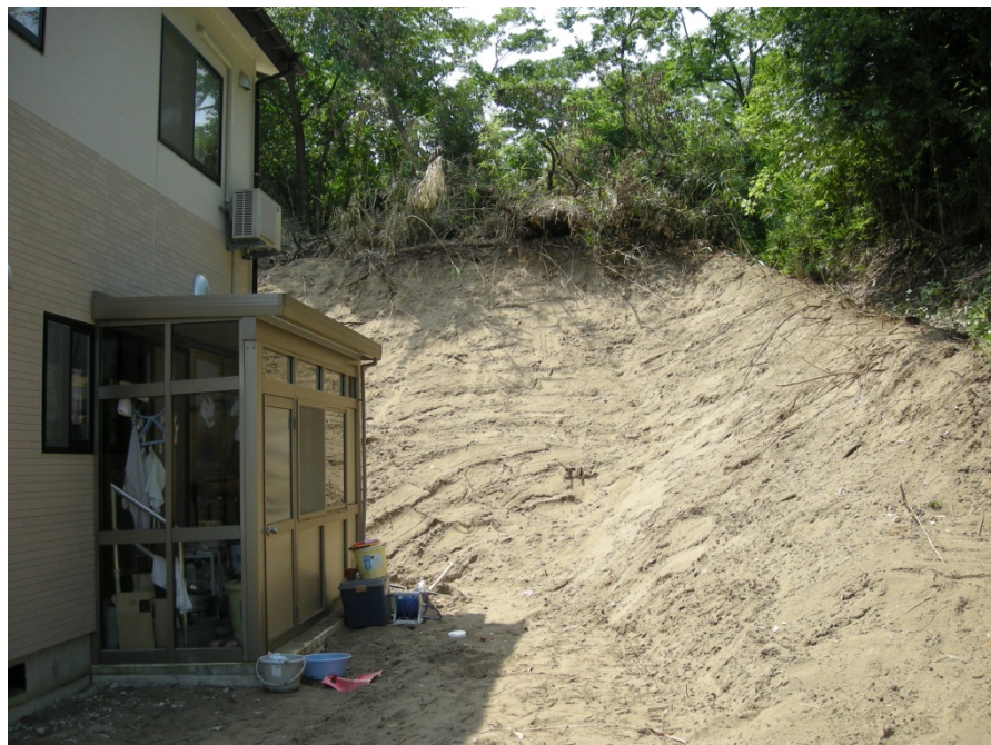
写真5.2.2 砂丘斜面の崩壊による建物の被害
