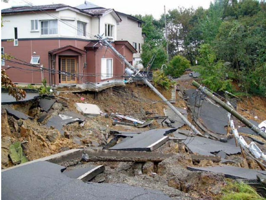
写真 2.2.4 盛土の崩壊 ((株) 興和提供)
