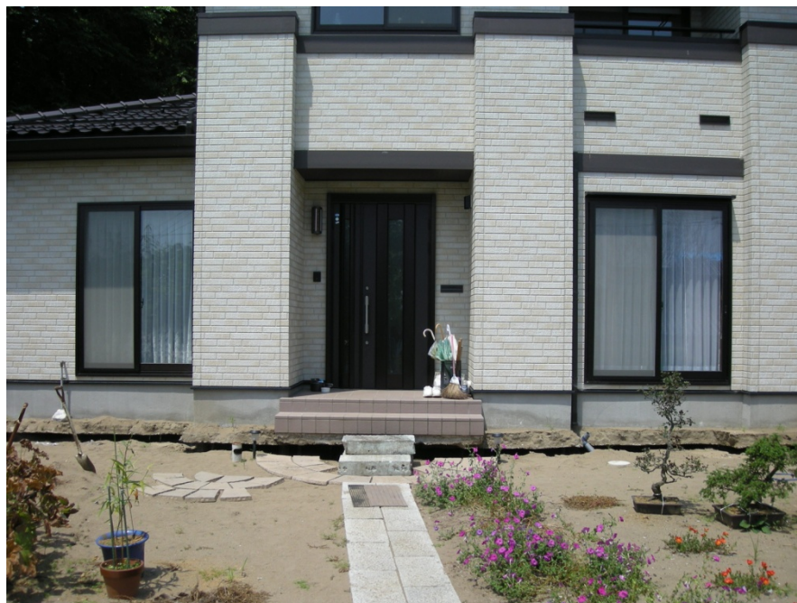
写真5.3.1 鋼管短杭打設した建物の被害（砂丘）
