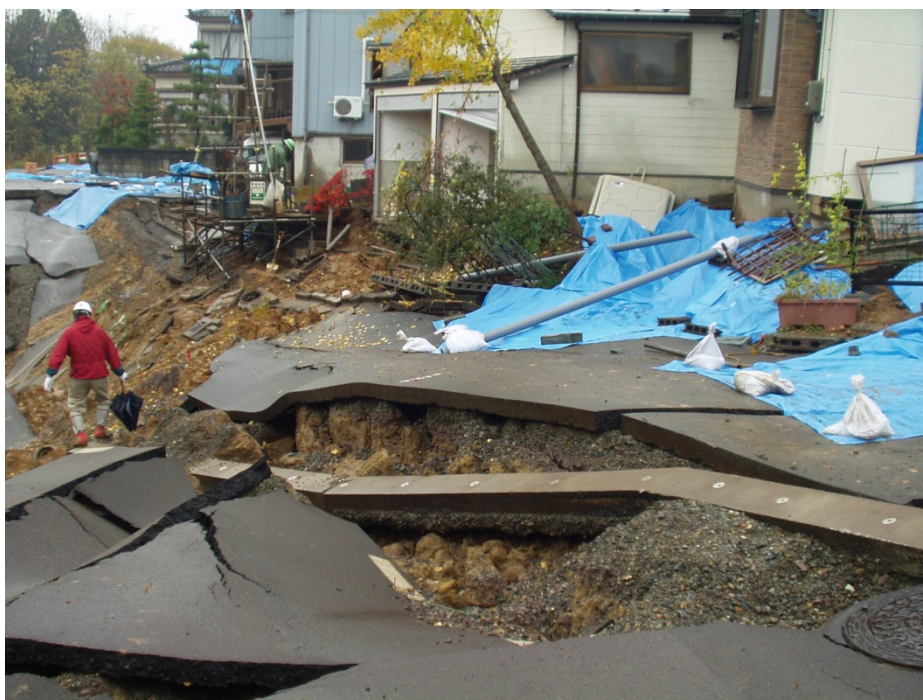
写真 2. 2. 2 盛土の崩壊による建物基礎の被害 ((株) 福田組提供)
