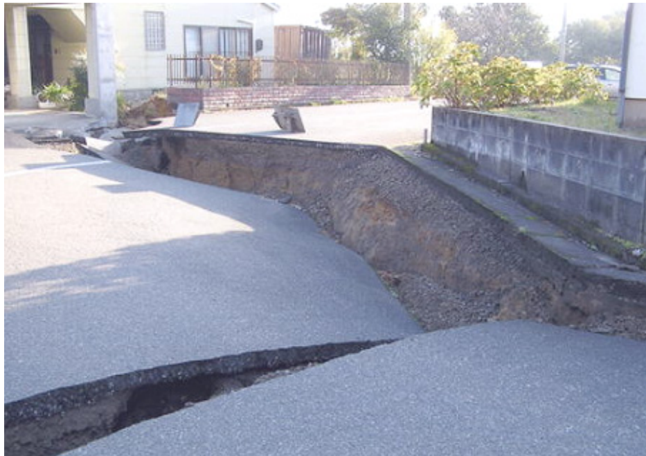
写真 2.2.1 高町団地周回道路の段差被害（(株) 福田組提供）
