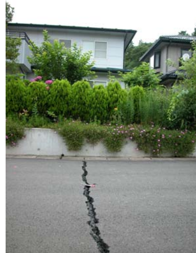
f 大塩地区 切盛境界部, 道路亀裂
