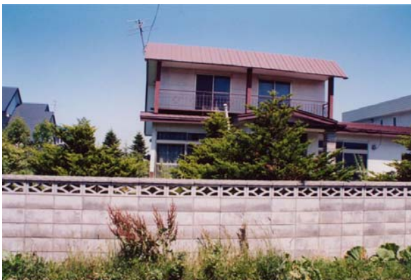
g 釧路市貝塚 切盛境界部, 右側が盛土部, 不同沈下による家屋の傾斜
