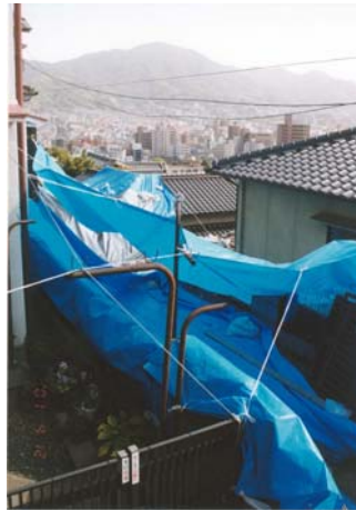
a(左) 呉市 階段アプローチ住宅地の被災 b(右) 同上 石積み擁壁の被災(シートの下)
