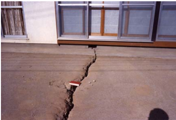
e 仙台市鶴ヶ谷 切盛境界部の亀裂と沈下 右側が盛土部
