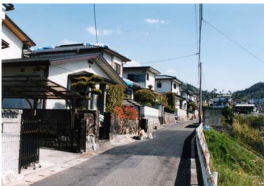
c 広島市安佐南区 盛土部の沈下, アスファルト補修跡
