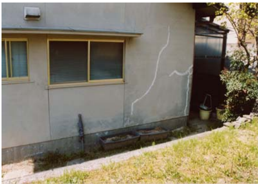
e 広島市安佐南区 切盛境界, 壁モルタルと基礎に亀裂
