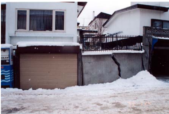
e 釧路市緑ヶ岡 切盛境界部, 左側が盛土部 コンクリート擁壁の亀裂
