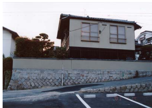
d 広島市西区 切盛境界か, 擁壁と塀に亀裂, 道路補修跡
