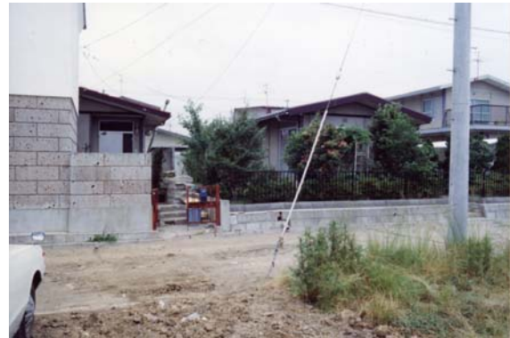
d 泉市南光台 切盛境界部の不同沈下 左側が盛土部
