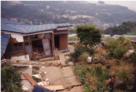
c 仙台市緑ヶ丘 盛土の崩壊
