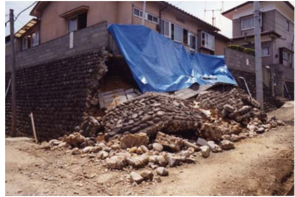
b 仙台市青山 盛土の擁壁の崩壊
