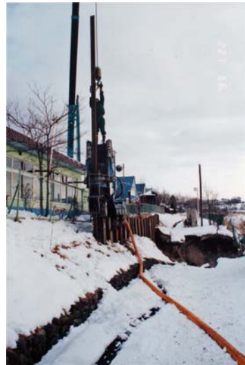
c 釧路市武佐 わかくさ幼稚園脇の 盛土斜面の崩壊
