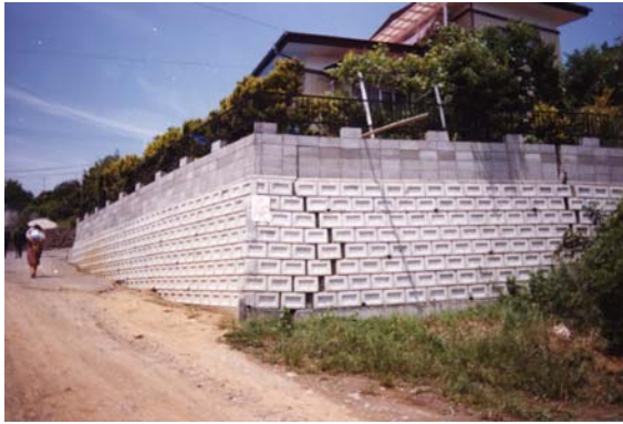
a 仙台市青山 盛土の擁壁の亀裂
