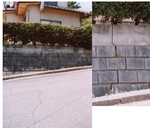
f 広島市安佐南区 切盛境界, 道路, 擁壁, 建物基礎に亀裂 右はその拡大写真
