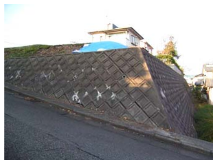
g 長岡市長峰団地 ブロック擁壁に亀裂
