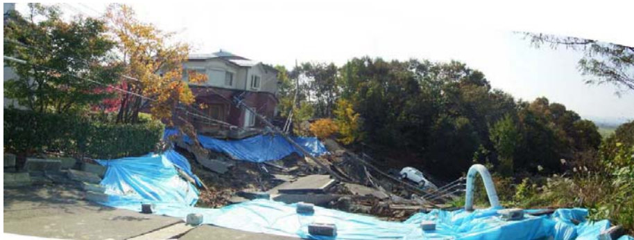
c 高町団地 団地縁辺部の盛土の崩壊
