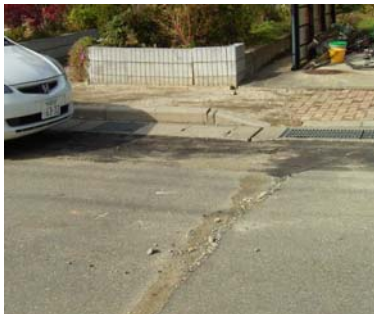
d 長岡市長岡ニュータウン(青葉台) 切盛境界部, 道路の亀裂
