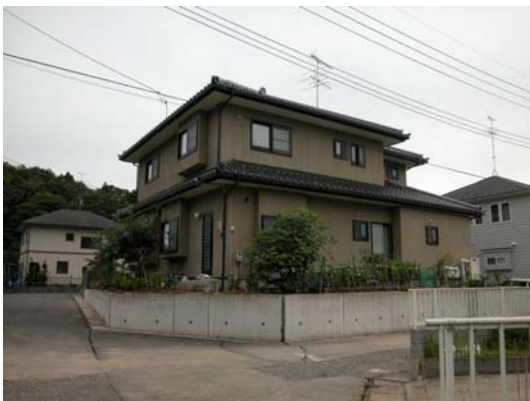
e 旧矢本町大塩地区 盛土部, 道路亀裂と擁壁の隙間
