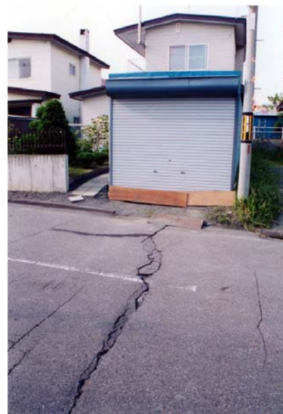
f 釧路市益浦 切盛境界部, 右側が盛土部, 道路亀裂 車庫の床が傾斜, 奥の母屋は無被害
