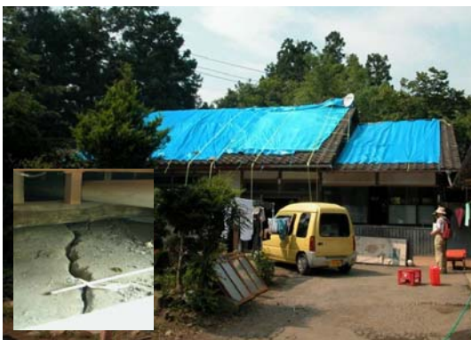
c 北村地区 左側盛土部の沈下と床下の亀裂
