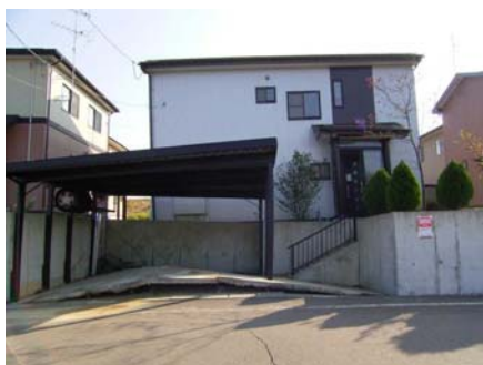
f 長岡ニュータウン(陽光台) 液状化による車庫地盤隆起, 家屋傾斜
