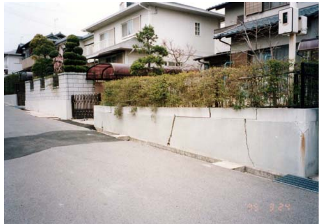
d 垂水区 C 団地 切盛境界部か, 道路亀裂修理跡, 擁壁亀裂 団地内の被害は少なくごく局部的
