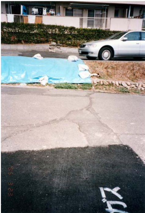
c A 団地 切盛境界部, 右側が盛土部, 段差のある亀裂, ガス管修理跡
