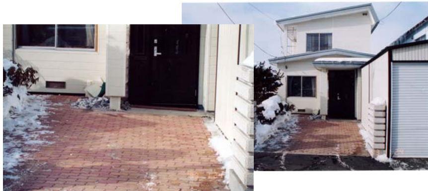
d 釧路市材木町 切盛境界部, 右側が盛土部, 不同沈下(玄関ドア下に隙間)
