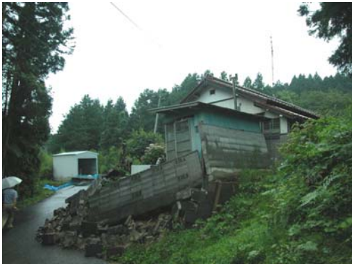
a 旧河南町北村地区 盛土擁壁の崩壊
