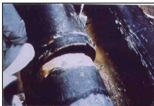
図 2.11 地盤の引張ひずみとせん断ひずみによる水平本管の破断
