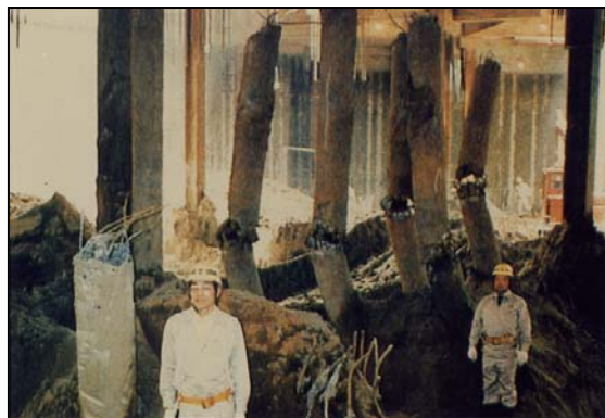
図 2.4 側方流動による杭の被害 (1964 年新潟地震,新潟市)
