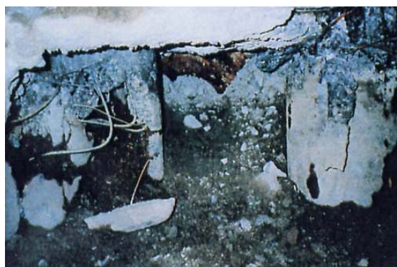
図 2.7 下水処理場本館建屋の基礎杭の被害(1995 年兵庫県南部地震,神戸市)
