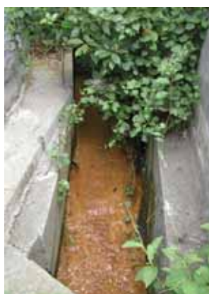
Fig.4-1-57 汚染地下水流出
