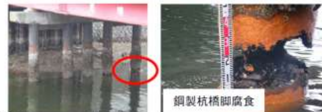
【重大な損傷の事例(橋梁)】
