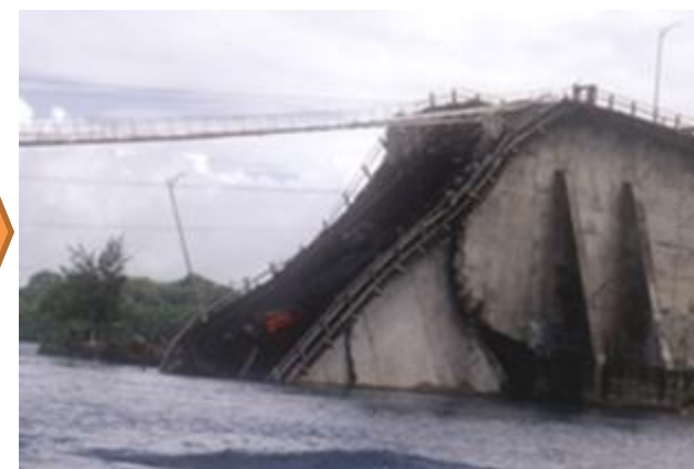
崩落した様子
