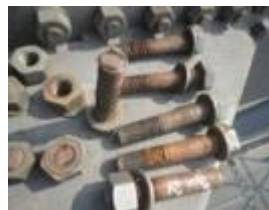
破断した既設ボルト
