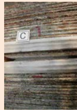
主ケーブル内赤さび発生
